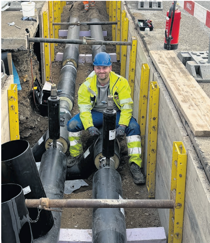
Was gibt es Schöneres, als wenn die Arbeit Freude macht. Leitungsbau an der Schulstrasse in Frick.
